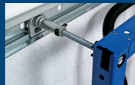
↑ Montážny prvok Geberit Duofix umiestnite do správnej pozície. V predstavenovej inštalácii na čiastočnú výšku miestnosti ho ukotvite pomocou montážnej súpravy...
